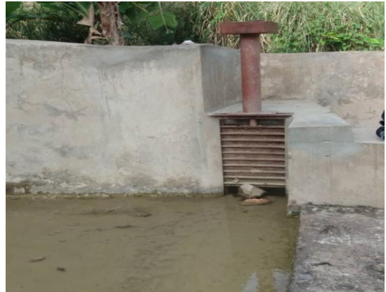
Figure 6 : Vue de la vanne d'admission
