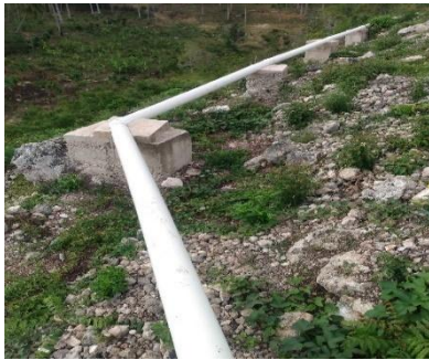
Figure 10 : Vue du premier tronçon canal primaire en PVC
