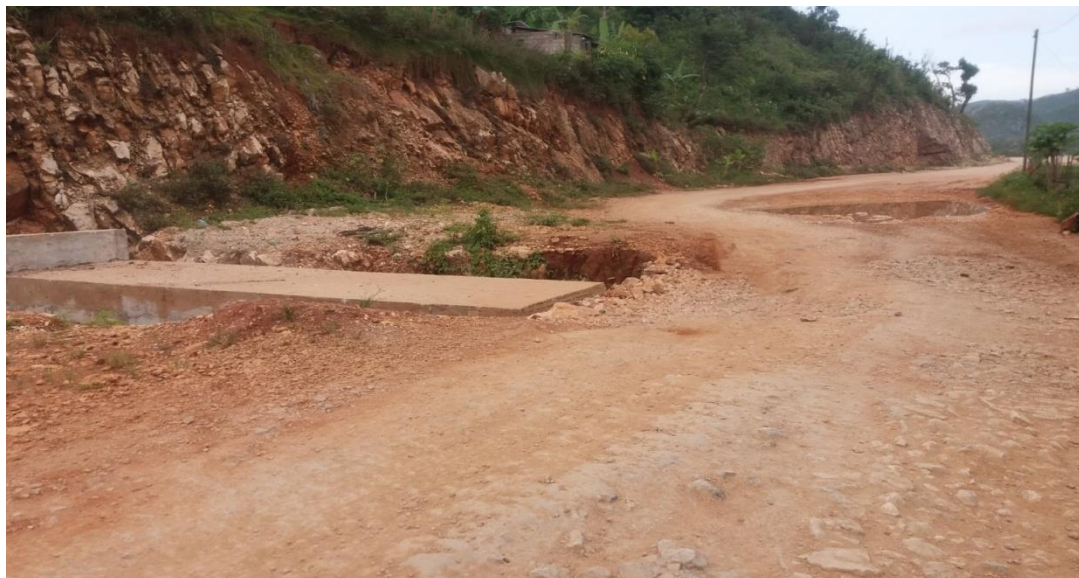
Travaux de drainage inachevé, Duchity
