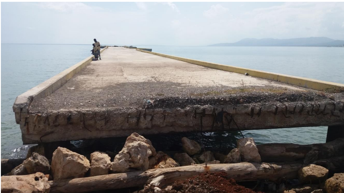
Détérioration du nouveau wharf de Jérémie
