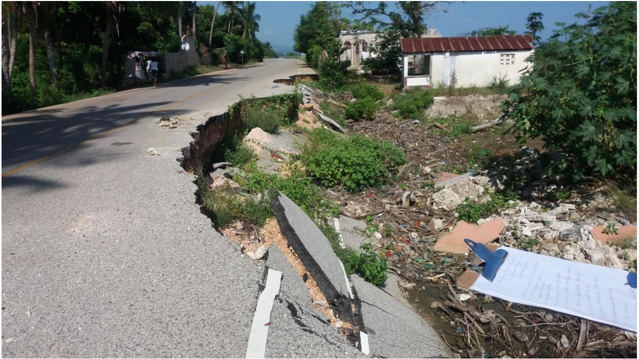
Effondrement de la route dû au non traitement de la base
