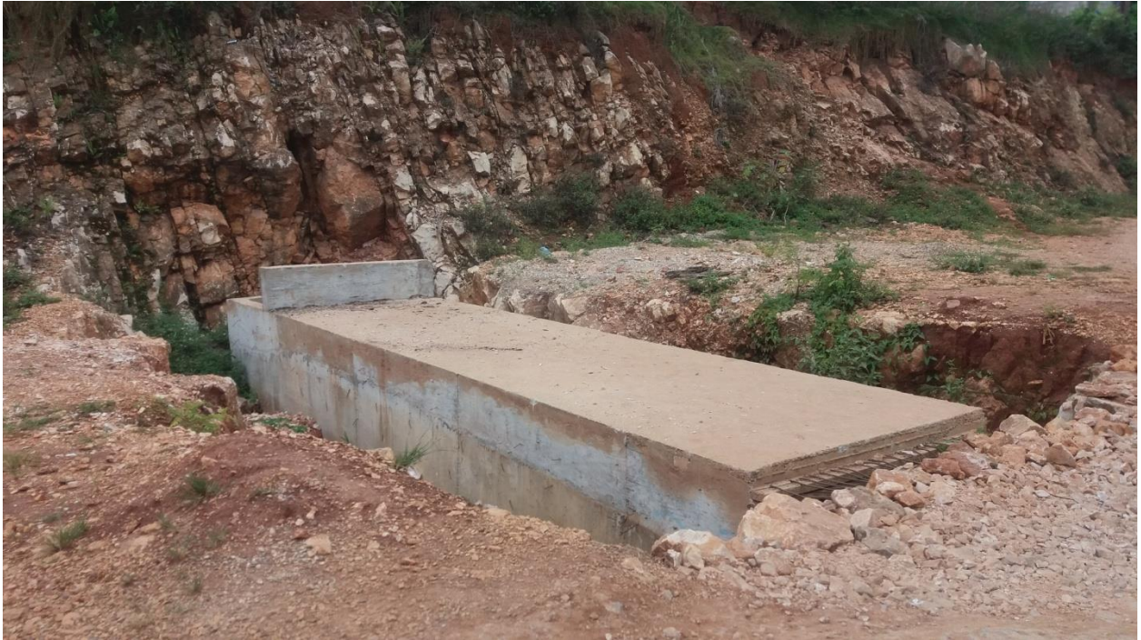
Travaux de drainage inachevé
