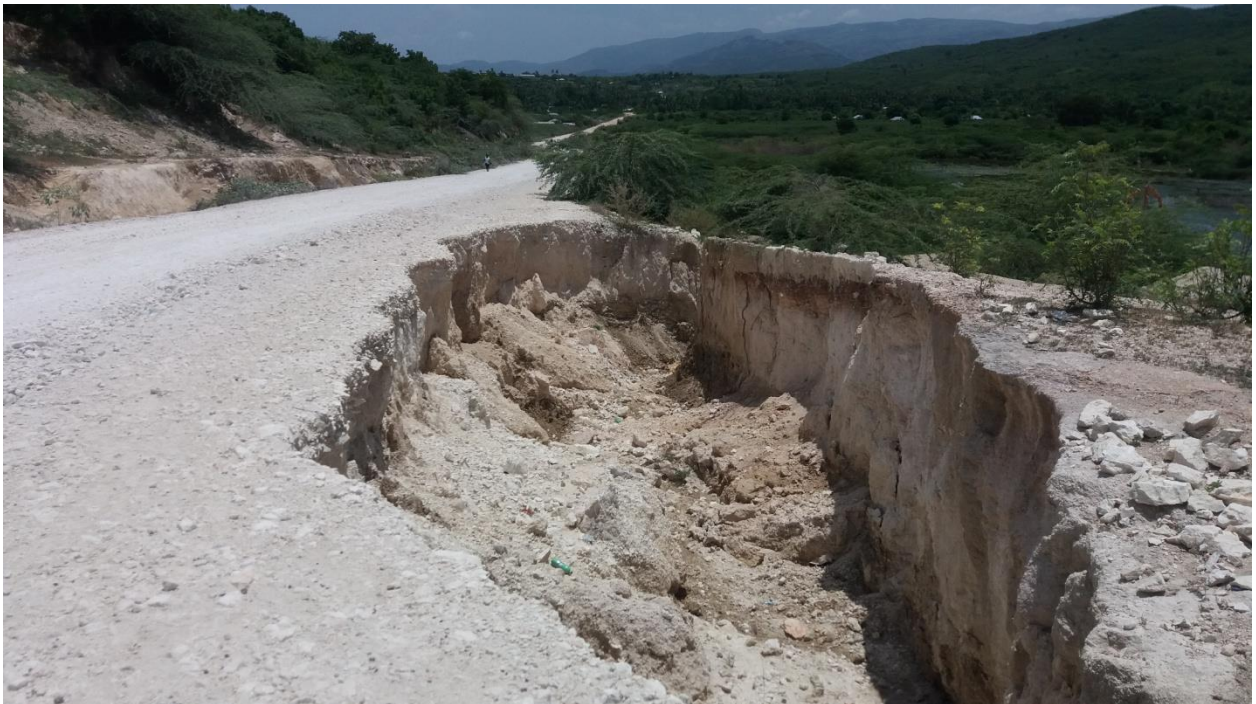
Effondrement des couches de base du tronçon Petite-Rivière/Petit-Trou de Nippes
