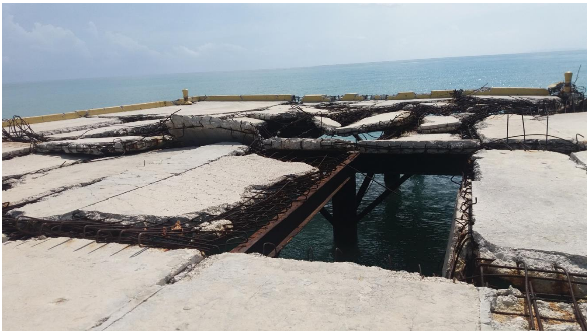
Détérioration du tablier du wharf
