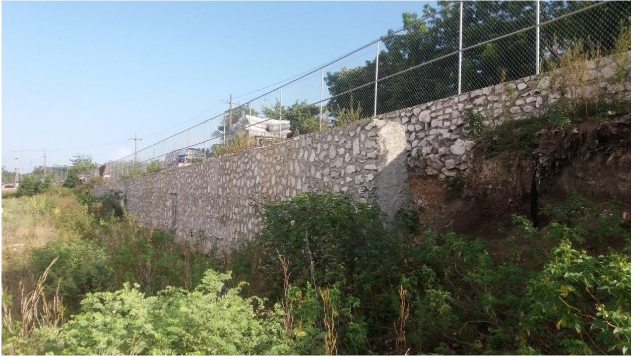
Mur de soutènement inachevé
