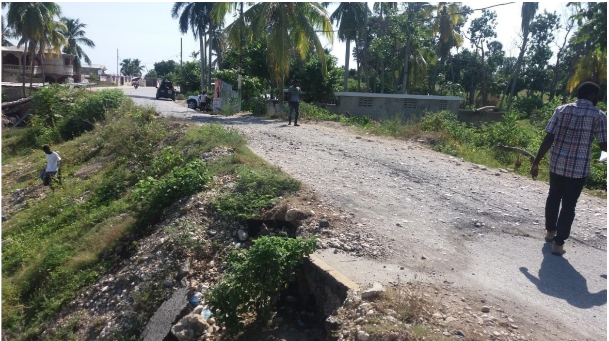
Détérioration de la chaussée dû au problème de drainage
