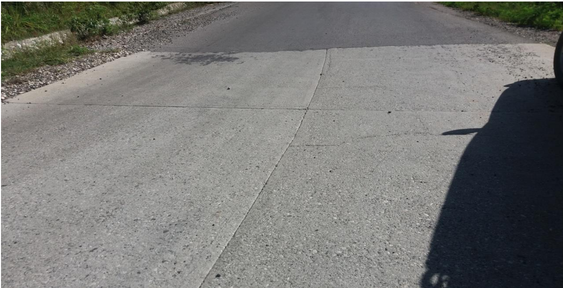
Connexion de la chaussée en béton hydraulique et celle en béton bitumineux
