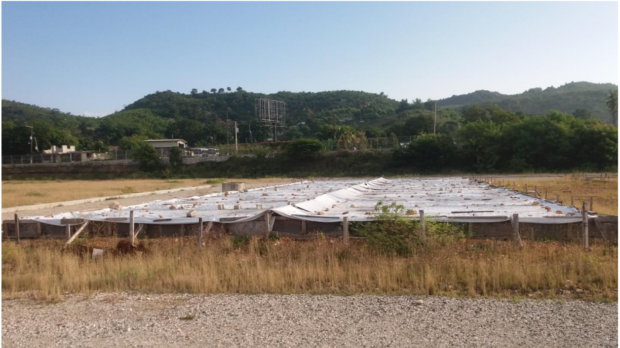
Parquet ferrillé et couvert pour éviter la rouille
