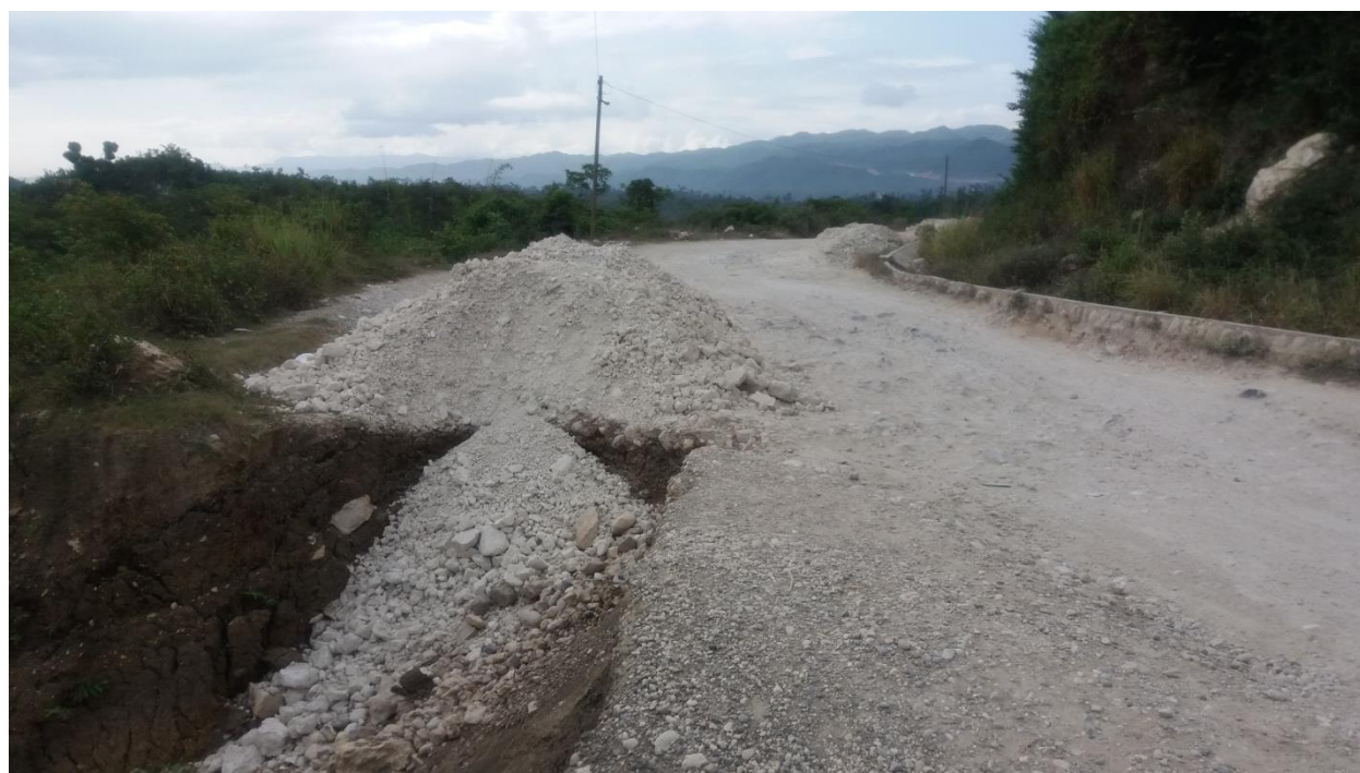
Effondrement de la base de la route Cayes-Jérémie
