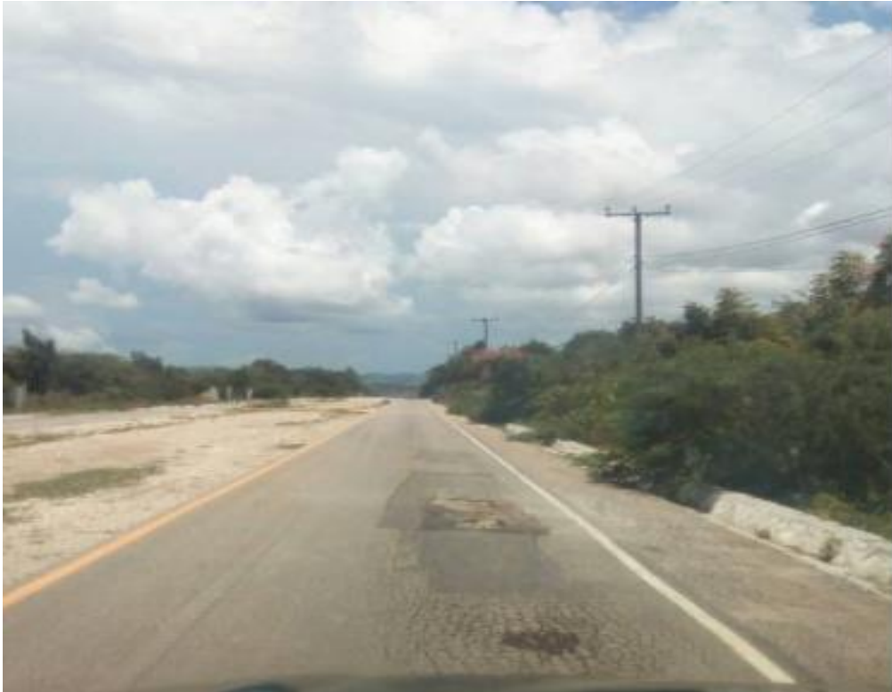
Route Carrefour 44/Cotes-de-Fer en dégradation
